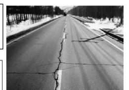
凍上災害による舗装の損傷事例
