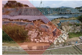
法面保護工が崩れて流出した事例
